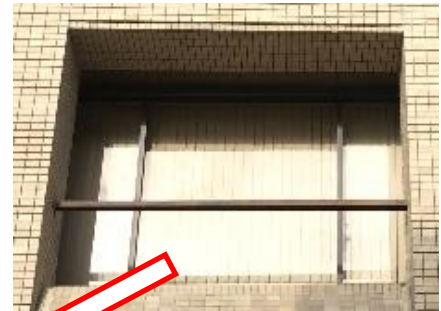
幅170cmの中央ガラスに設置
