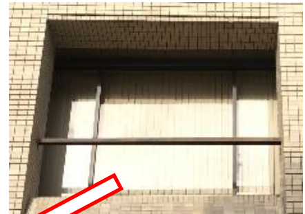
幅170cmの中央ガラスに設置
