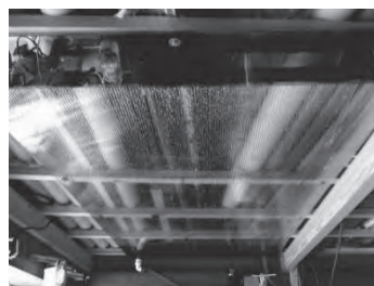
図 12 輻射冷房写真
