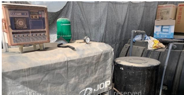
液肥コントローラー(左)、給水タンク(右奥)
