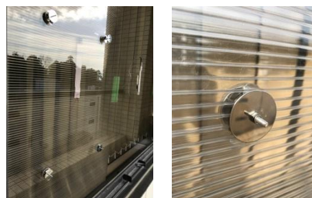
図 23 特殊ボルトとガラス面取付、ポリカ取付 柏市市役所での実証試験中
